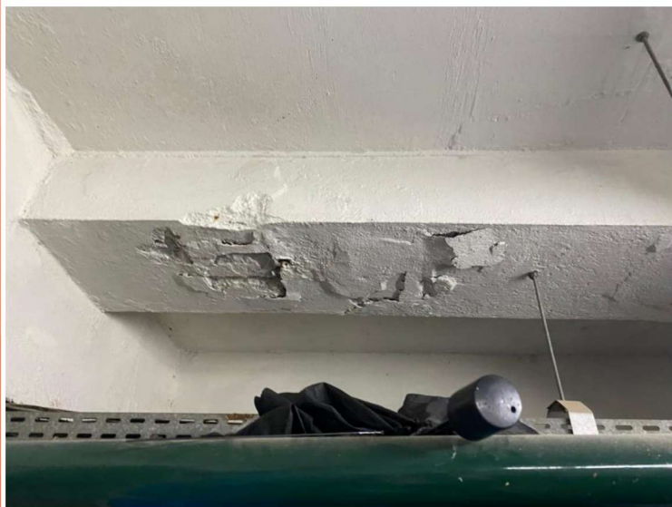
Foto 7: Viga – Armadura Exposta
