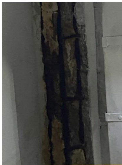
Foto 8: Viga – Armadura Exposta
